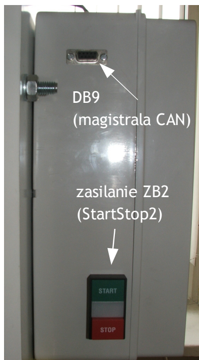
Rys 6. Skrzynka sterownicza ZB2 (widok z boku)
