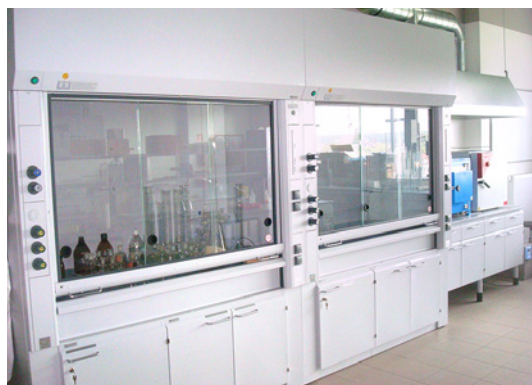
Fot. 3. Dygestoria oraz okap w jednym z pomieszczeń CDWTCh PP
